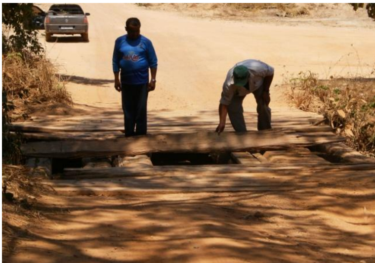
Fotografia 2 - Homens improvisando tabuas na ponte
