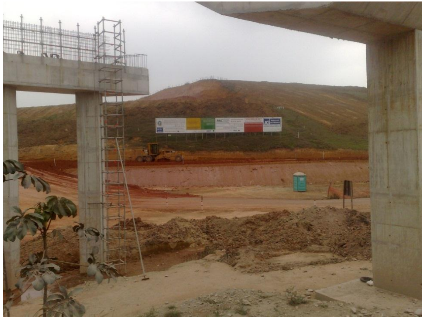
Fig. 48. Obra em andamento para construção do Anel Viário. Ligação entre Xerém e a Zona Oeste do Rio de Janeiro (via Itaguaí). Fonte: arquivo da pesquisadora.
