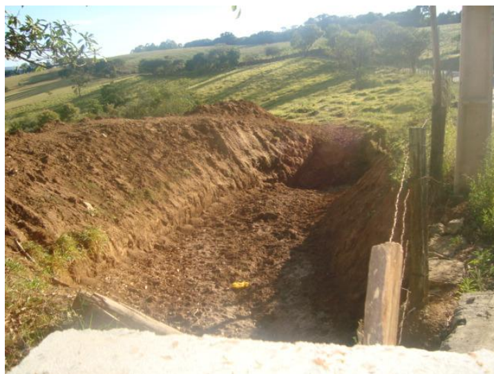
Figura 6.18 – Barreira de contenção construída pelo proprietário para evitar assoreamento das nascentes
