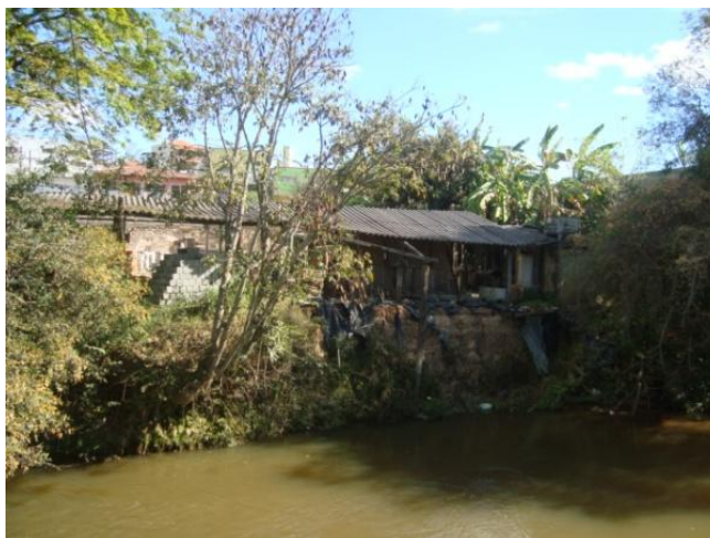
Figura 5.17 – Ocupação das margens do rio do Pinhal por empreendimento comercial (fábrica de bloco)
